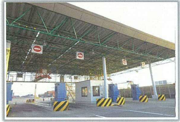
ゲート屋根部分糞害対策
